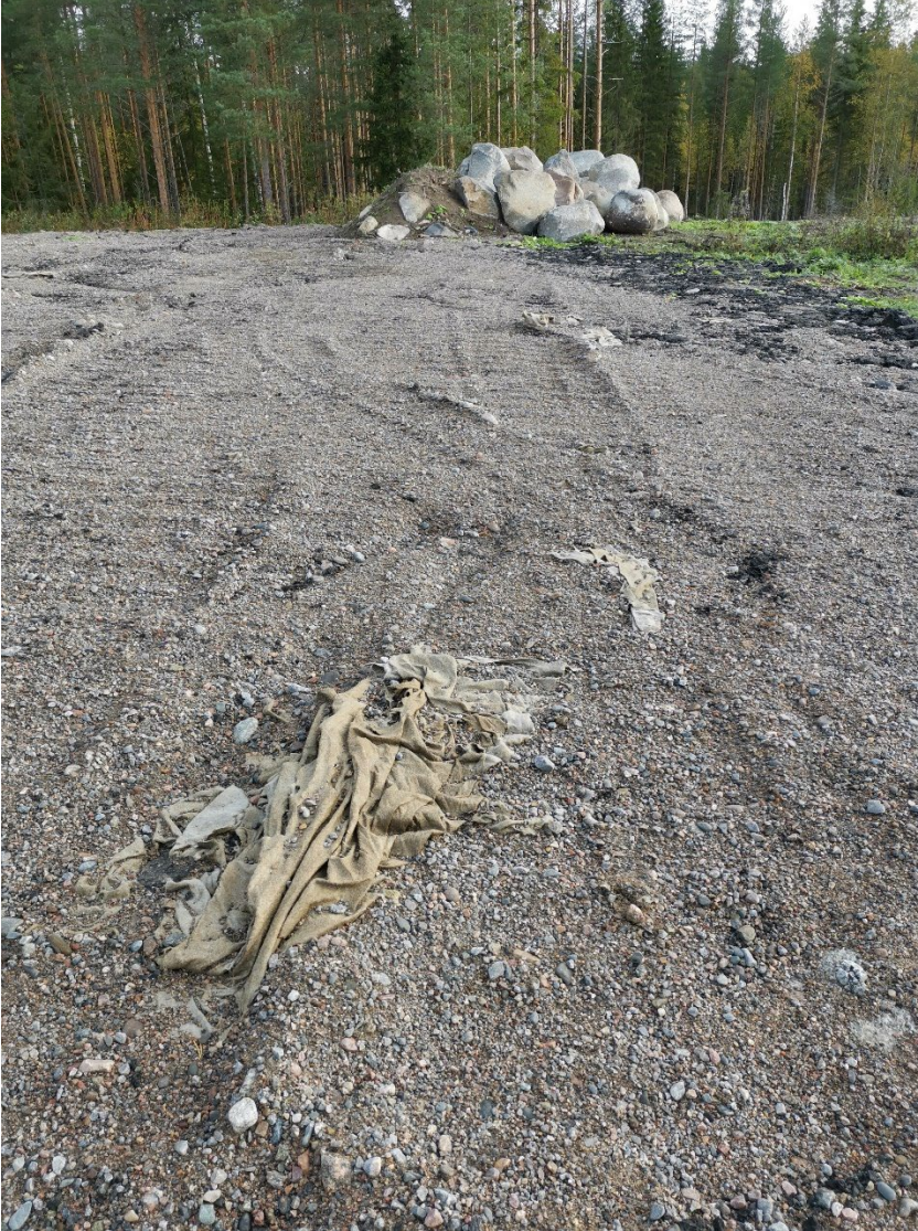
Kuva 3. Suodatinkankaita, joita ei edellisellä tarkastuksella havaittu.
